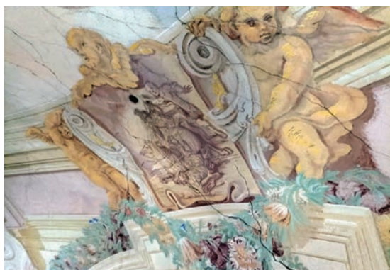
Popraskaná klenba v opatském chrámu
