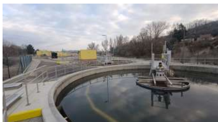
ČOV Boskovice - dosazovací nádrž
