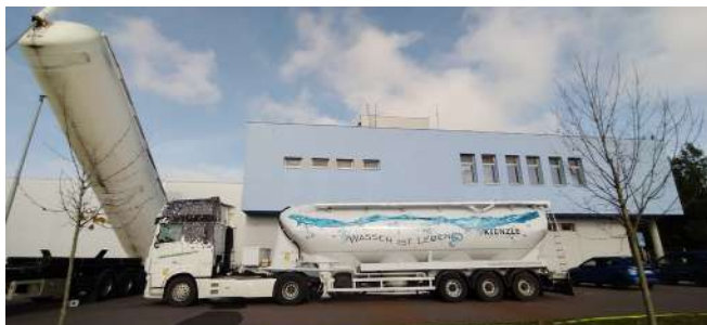
Doprava a naplnění filtrů 130 m 3 nového GAU na ÚV Znojmo probíhalo z autocisteren
