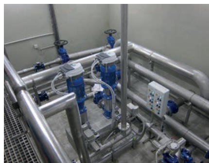
Vystrojení armaturní komory vodojemu Větrák Jedovnice
